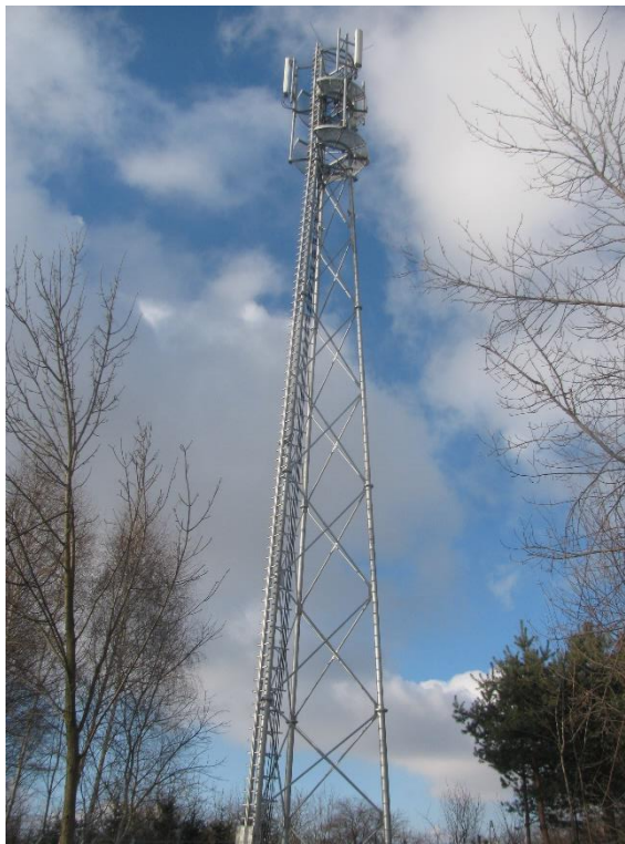
Zał. nr 1: Widok ogólny instalacji radiokomunikacyjnej.
