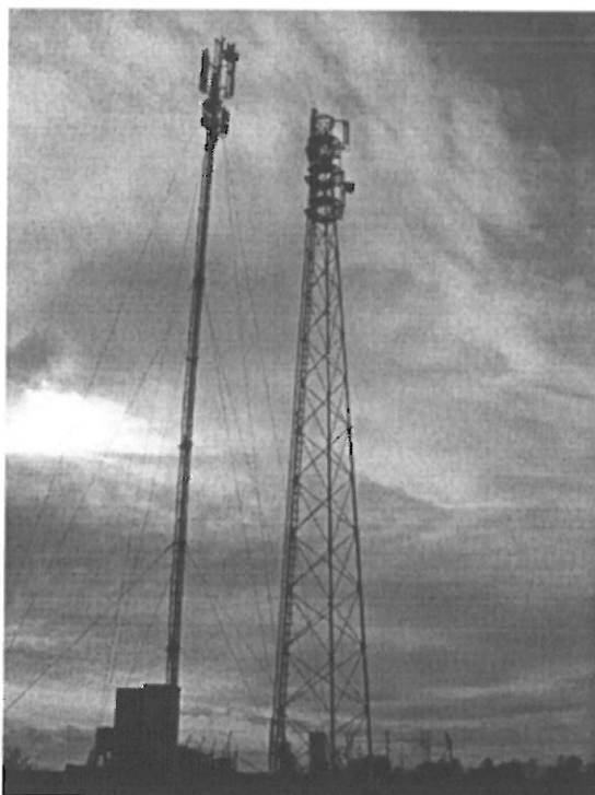
Zał. nr 1: Widok ogólny instalacji radiokomunikacyjnej.
