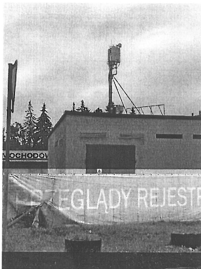
Zał. nr 1: Widok ogólny instalacji radiokomunikacyjnej.
