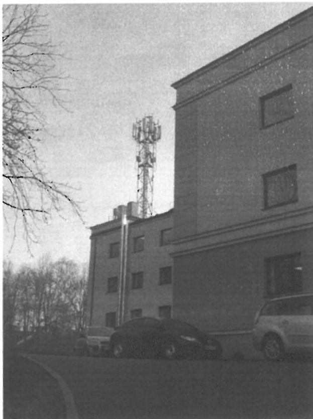
Widok obiektu wraz z zainstalowanym zespołem antenowym
