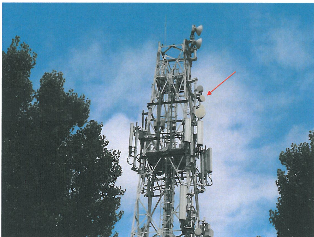
Widok instalacji radiokomunikacyjnej Stacja Netia BEDNT001 - BEDNM00001ANT020 Będzin, ul. Rewolucjonistów 7.
