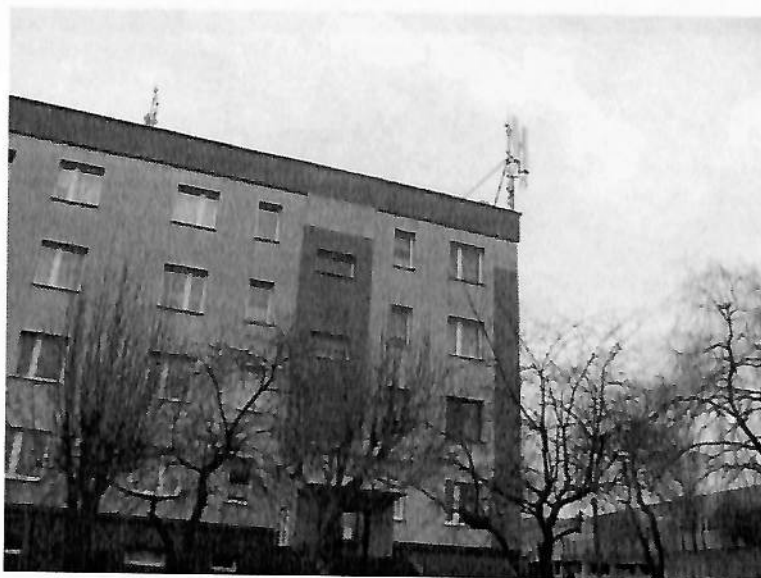
Zał. nr 1: Widok ogólny instalacji radiokomunikacyjnej.
